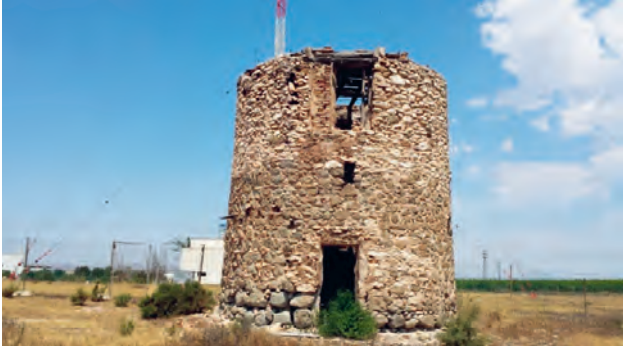
Figura 13: Molino harinero del Capitán González de Sepúlveda pre-clasicista con la base de la torre bastante dañada (2016). Fuente: El autor.
